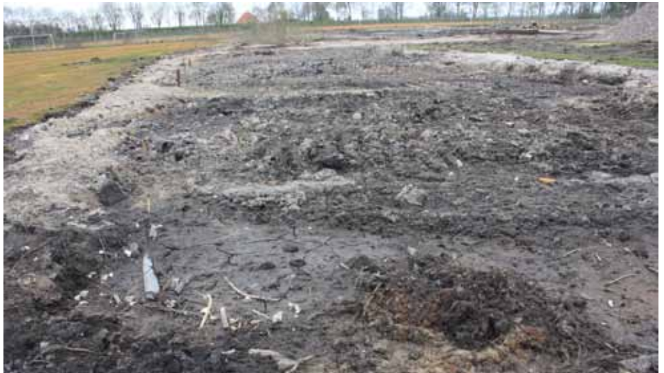
De bodem onder het hoofdveld was flink geroerd, waardoor een standaard onderbouw niet mogelijk was.
