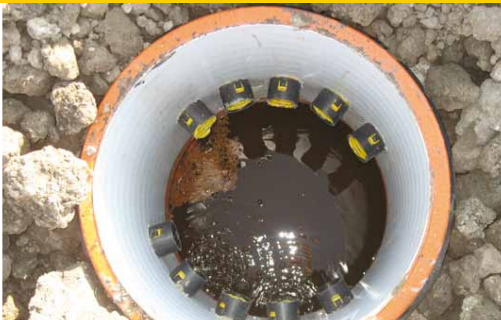
Verzamelput waarop een aantal drains uitkomen.
