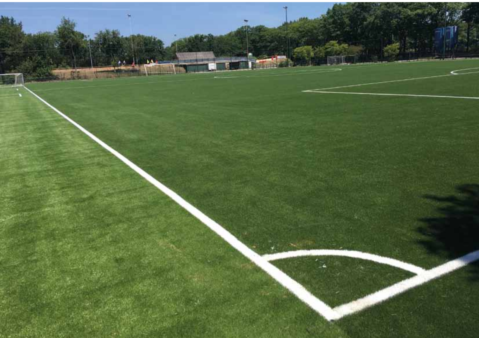
Twee non-infillvelden die in Schijndel momenteel worden aangelegd, worden aangebracht op de aanwezige shockpads.
