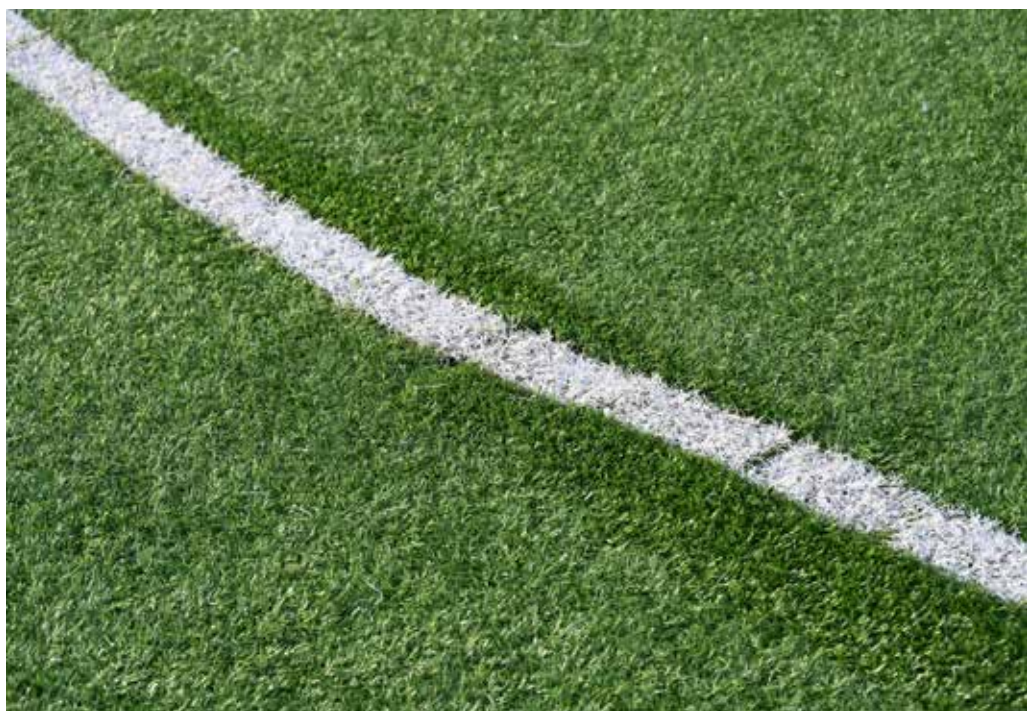
Wat lastig te zien, maar op deze plek bij de middencirkel is de mat losgekomen van de lijmband en gerepareerd
