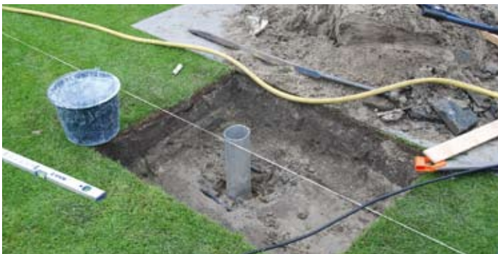
Een doel plaatsen is een secuur werkje. In Amsterdam zijn de betonpoeren in de bodem afgezworen. Stevig verankeren gebeurt hier met aluminium kokers in de bodem.
