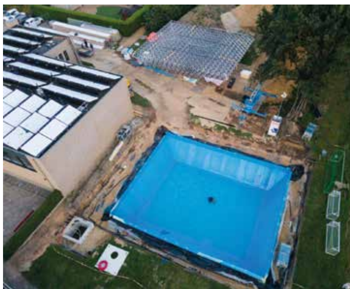
Vorbereiding van het graafwerk voor het plaatsen van de waterbuffer. De dakconstructie voor de later te plaatsen zonnecollectoren is al gereed.
