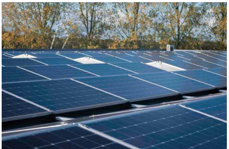
Het pand van SKOR in Almelo is voorzien van 650 zonnepanelen.
