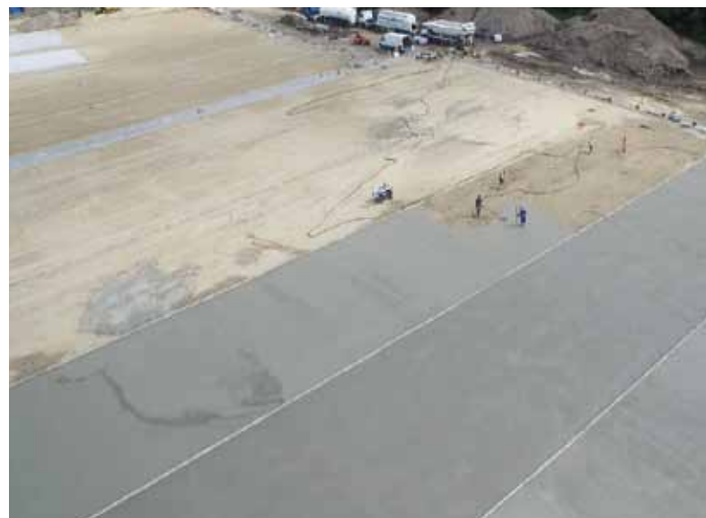
De kalk uit het schuimbeton wordt nu gezien als vervuiler van een nabijgelegen sloot.
